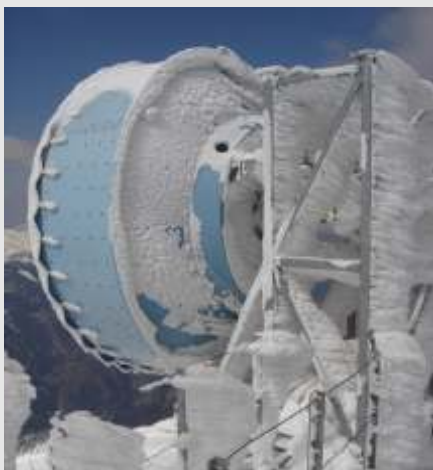
Ortsfeste Richtfunkantenne im Winter
