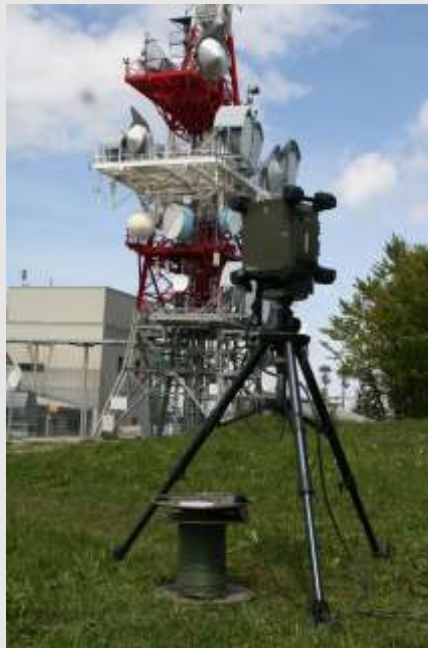
Verlegbares Richtfunksystem vor Antennenanlage des ortsfesten Richtfunks
